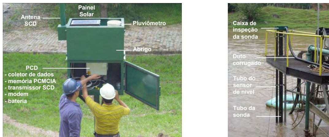
Figura 2 – Detalhes da instalação da PCD de qualidade de água
