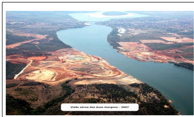
Figura 1: Início das obras da Usina Hidrelétrica de Estreito – MA em 2007. Fonte: Google 2023
