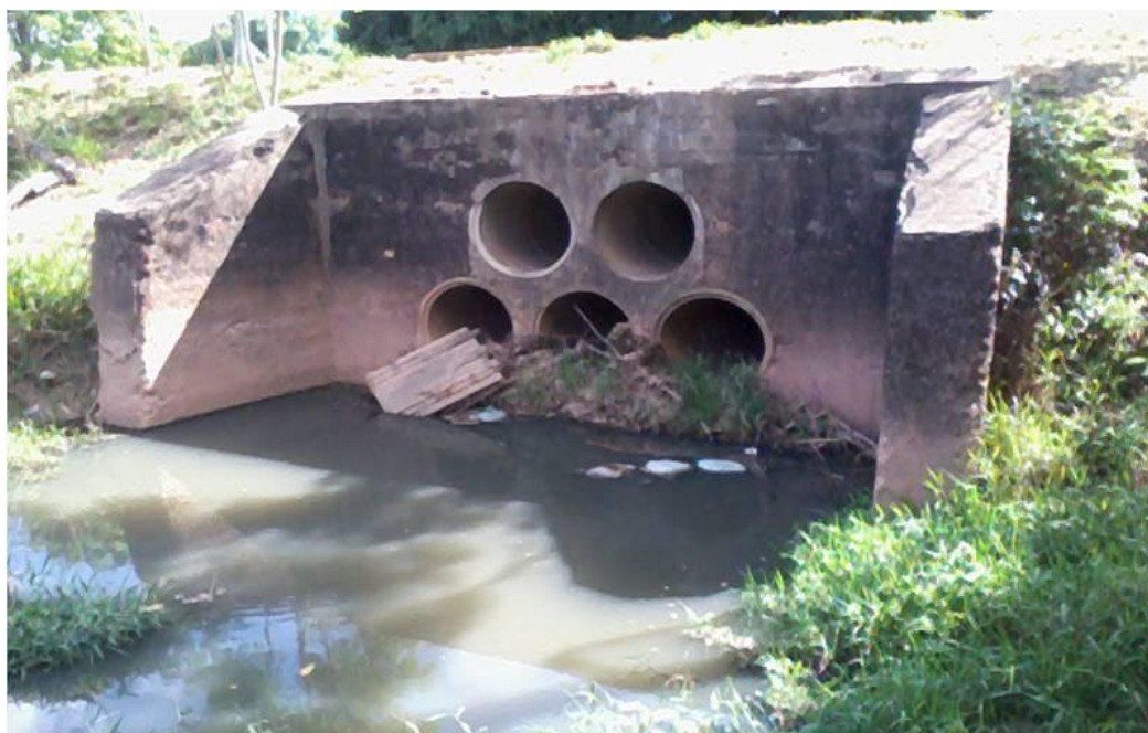
Figura 6. Bueiro entupidos por sedimentos sob a BR 010 sentido Belém –Brasília (2013).
