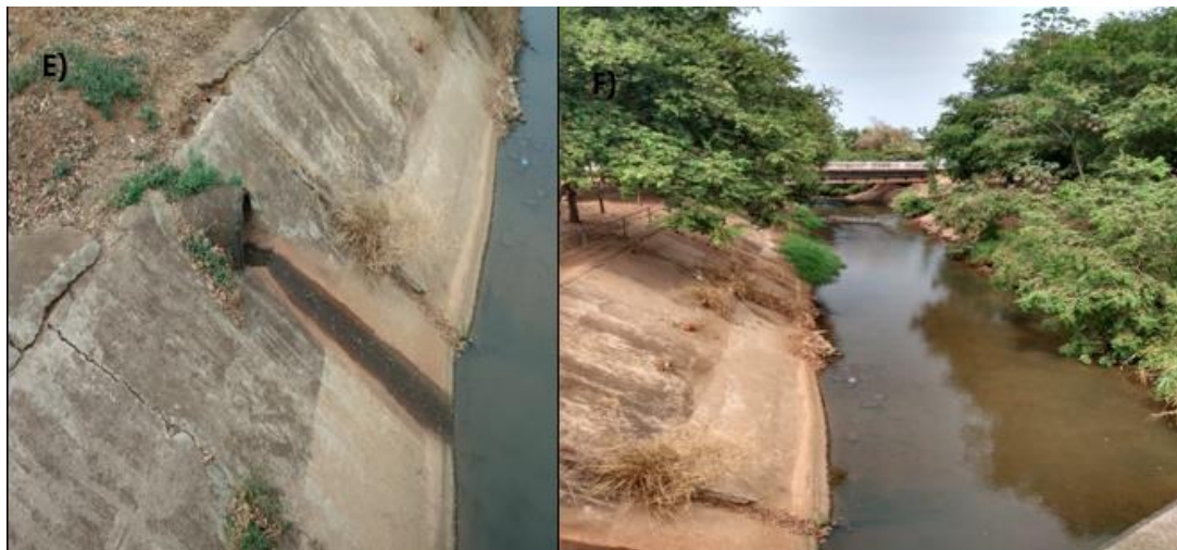
Figura 6. Rio Anta Atirada no centro da Cidade de Rolim de Moura. (E, F) demonstram um dos encanamentos que despeja resíduos no rio, além de conter alguns dejetos e mal cheiro.
