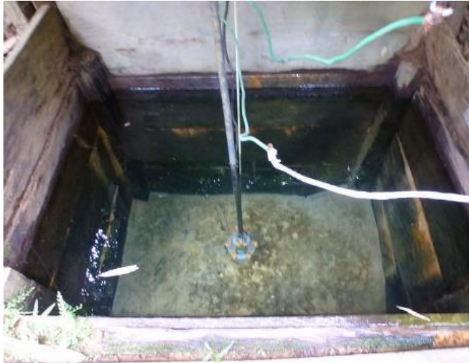
Figura 2 - Captação de água em nascente
